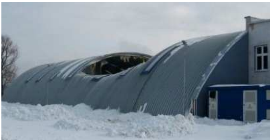
Rys. 3. Widok ogólny hali magazynowej w Gdańsku po katastrofie 16.02.2010 r.
