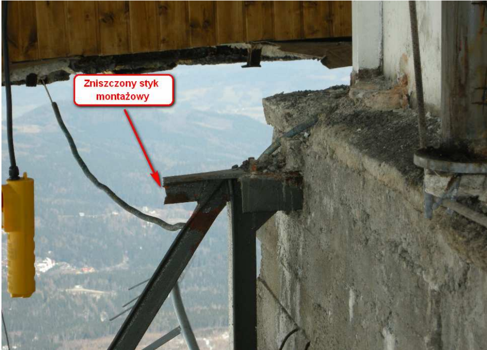
Rys. 7. Widoczne zerwanie pasa górnego kraty wspornikowej w miejscu wykonania spoiny
