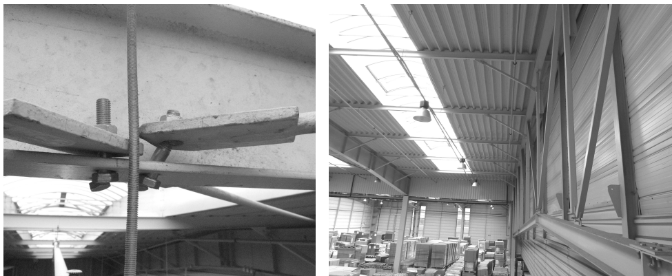
Rys. 10. Wadliwe mocowania stężeń dachowych do płatwi (a) oraz brak zastrzałów Z3 wg rys. 9 w wieszakach płatwi w osi A nawy 1–9'
