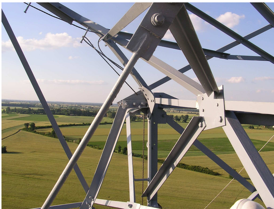
Rys. 2. Szczegół zniszczenia słupa na wysokości poprzecznika
