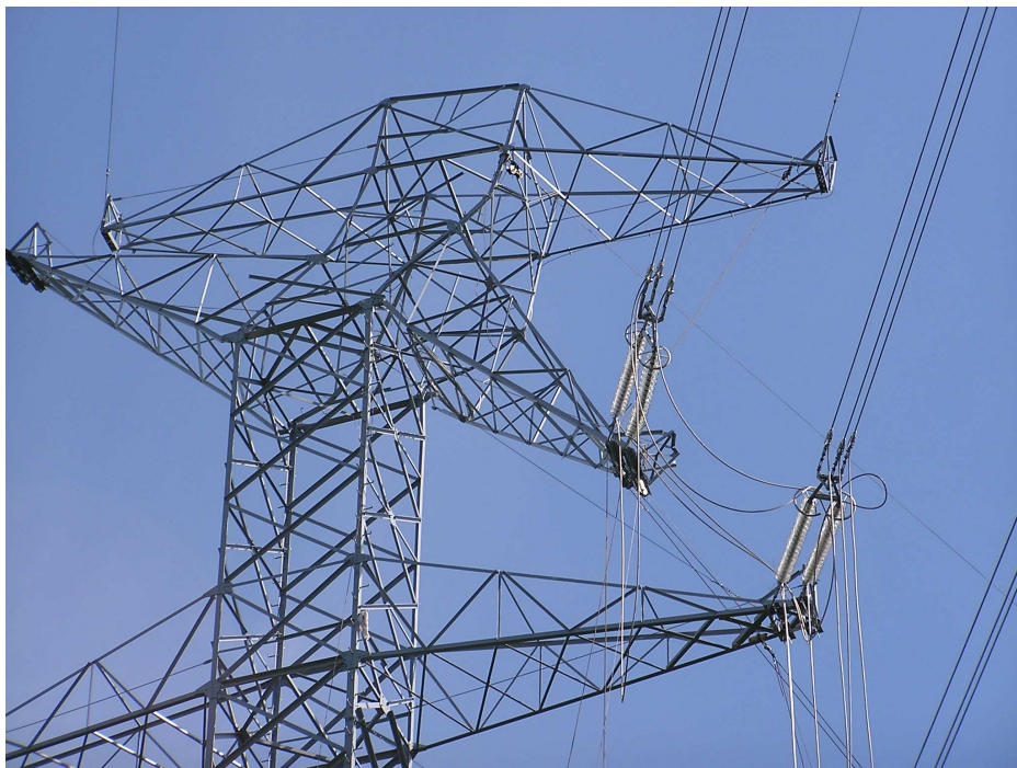
Rys. 1. Postać zniszczenia górnej części słupa
