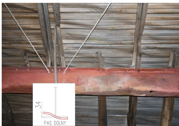
Rys. 6. Widok zdeformowanego pasa dolnego dźwigara
