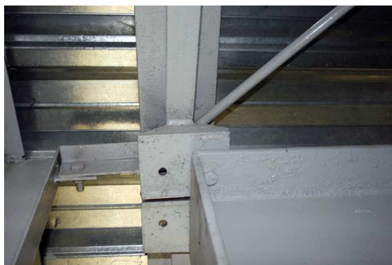
Rys. 5. Wadliwe oparcie płatwi skrajnych na dźwigarach dachowych
