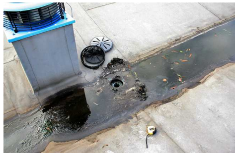
Rys. 8. Nie czyszczone wpusty dachowe segmentu dwunawowego
