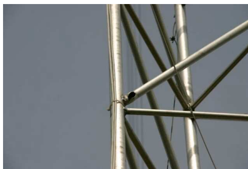
Rys. 4. Pęknięcie jak na rys.3, poz.+4,65m
