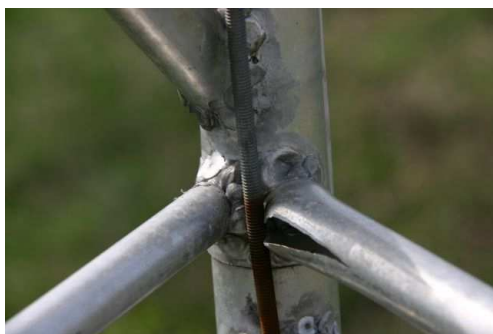
Rys. 3. Pęknięcie pręta w maszcie C
