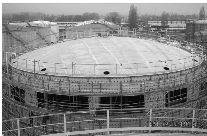
Rys. 8. Wycięte w płaszczu zbiornika fragmenty blach z ostrymi załamaniem oraz otwory w pokryciu dachowym służące do wprowadzenia słupów podporowych
