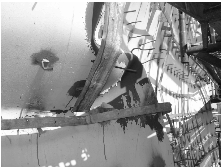
Rys. 2. Ostre załamania blach płaszcza widoczne po rozizolowaniu zbiornika
