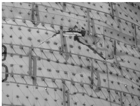
Rys. 4. Niewielki wyciek wody spowodowany pęknięciem blach płaszcza na ostrym załamaniu podczas rozłaczania hydrostatycznego
