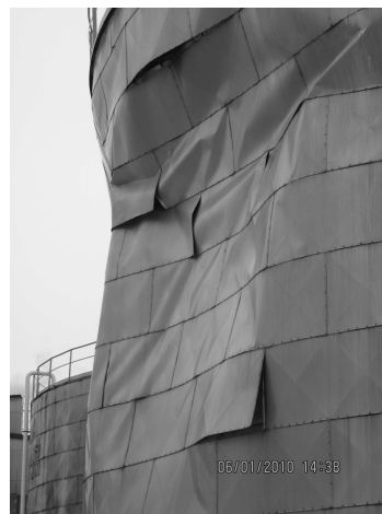
Rys. 1a. Zbliżenie deformacji blach płaszczu zbiornika
