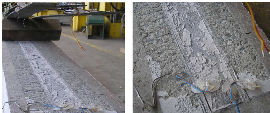
Rys. 9. Spód belki po delaminacji taśm A i B (zniszczenie kohezyjne w betonie – kruche) oraz taśmy C (zniszczenie kohezyjne w polimerze – ciągliwe)
