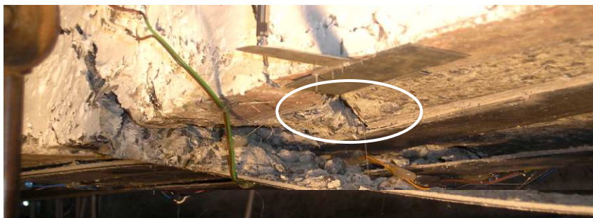
Rys. 8. Taśma C/PXBM utrzymująca belkę, w początkowej fazie niszczenia połączenia polimerowego
