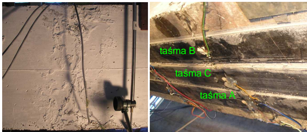
Rys. 3. Ściana boczna i podstawa belki w miejscu naprawy pęknięcia (na początku badania)
