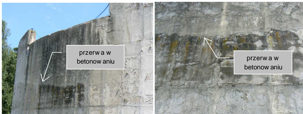
Rys. 5. Widoczne niejednorodne obszary betonu – strona południowo-zachodniej zbiornika nr 1
