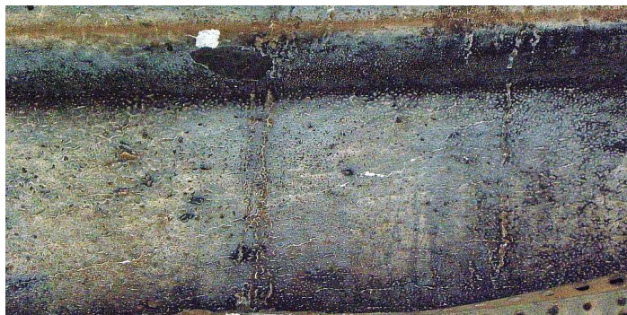
Rys. 4. Widok zarysowań dźwigara strunobetonowego
