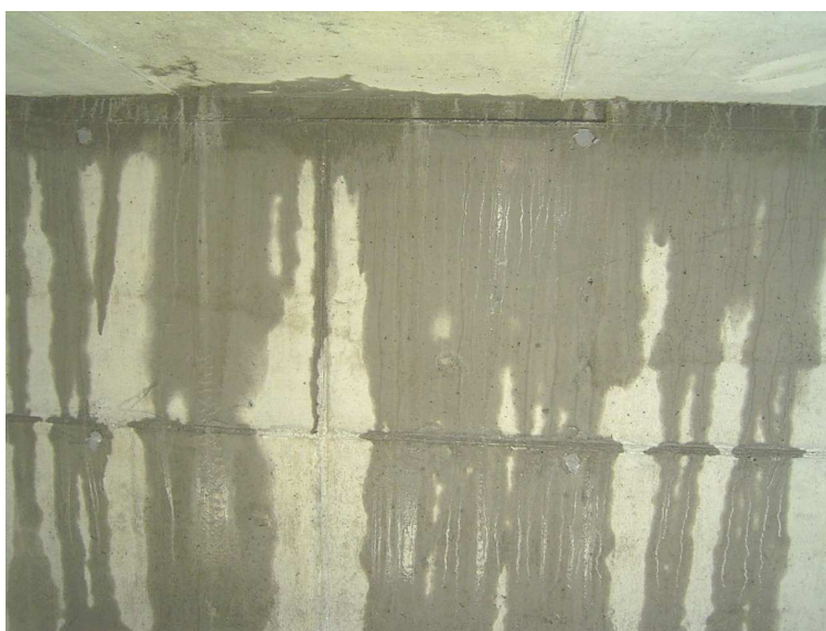
Rys. 6. Przeciek między komorami – górna przerwa technologiczna
