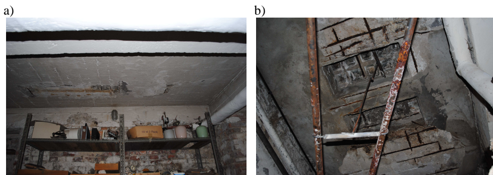
Rys. 2. Usterki stropu nad piwnicą w obszarze pomieszczenia kotłowni: a) pełnościenny fragment stropu, b) fragment stropu z wypełnieniem pustakami szklanymi
