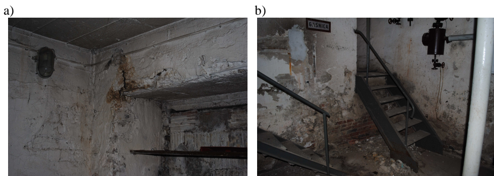
Rys. 3. Pomieszczenie kotłowni: a) usterki żeber stropu w postaci zarysowania strefy przypodporowej oraz odsłoniętych prętów zbrojeniowych b) widok ogólny pomieszczenia kotłowni z pokazaniem zakresu uszkodzeń wilgotnościowych
