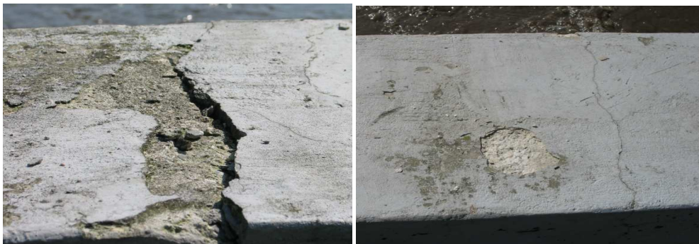
Rys. 3. Zarysowania górnej powierzchni ścian zbiornika
