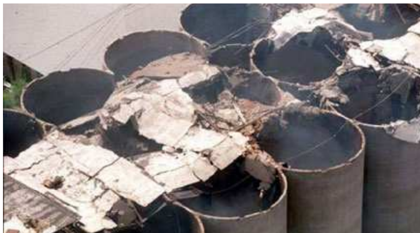
Rys. 1. Przykład zniszczonego w wyniku wybuchu pyłów stropu nadkomorowego w baterii silosów zbożowych
