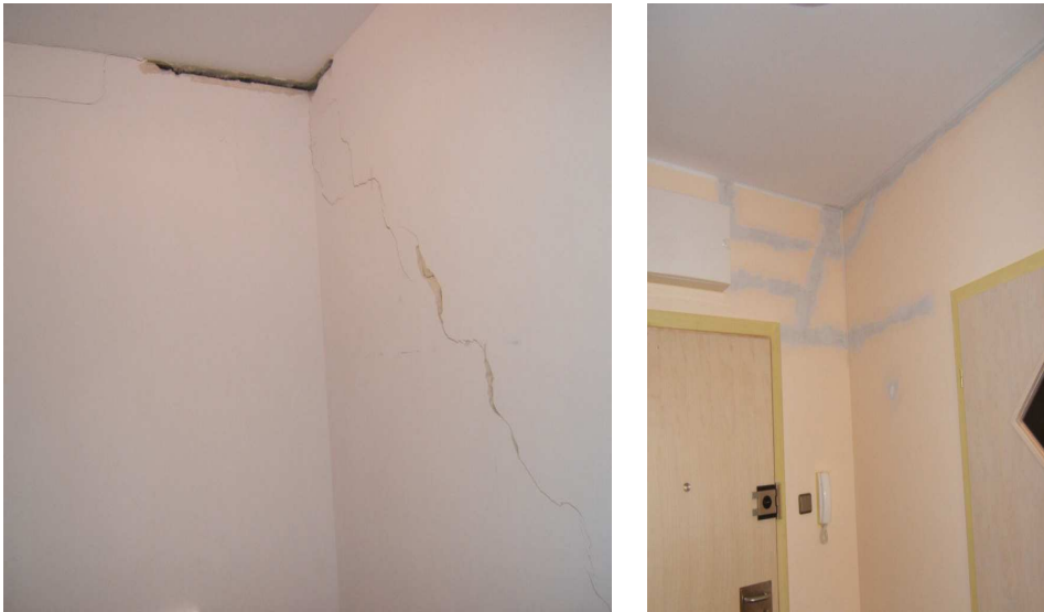
Rys. 3. Spękania i zarysowania ścian działowych: a) układ spękań i zarysowań ściany w osi L , b) wyprawione gipsem zarysowania w ścianie silikatowej oraz gipsowej
