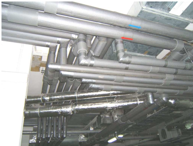
Rys. 4. Obszar intensywnego zagęszczenia rur instalacyjnych podwieszonych do konstrukcji stropu Filigran (strop nad poziomem -1)
