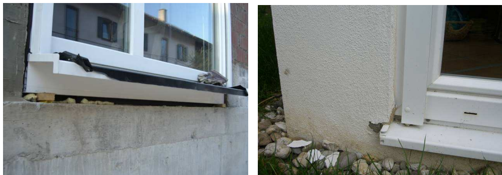
Rys. 4. a, b. Po lewej stronie brak uszczelnienia styku pod oknem. Wystające kliny użyte do montażu okna uniemożliwiają wykonanie uszczelnienia przez doklejenie powłoki izolacyjnej
