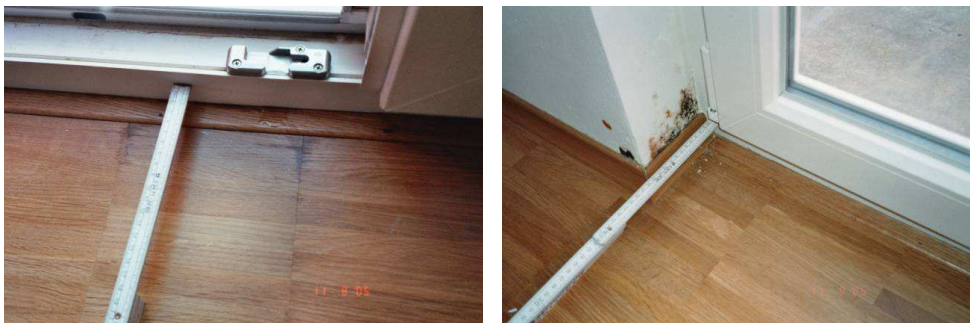
Rys. 7 a i b. Stan w pierwszym miesiącu po przekazaniu i zasiedleniu nowego mieszkania. Mieszkanie nie było przez użytkowników regularnie wietrzone – rano brak czasu, wieczorem po pracy brak chęci, z powodu zimna na zewnątrz. Po pięciu dniach, z dwoma pięciominutowymi wietrzeniami przez autora referatu, widoczne szkody ustąpiły
