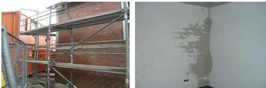
Rys. 5. a, b. Brak rury spustowej lub odprowadzenia wody poza obszar rusztowania powoduje (przez zalewanie ściany oraz odpryski od podestów rusztowania) zawilgocenie muru, które uniemożliwia wykonanie w tym stanie elewacji oraz może uszkodzić gotowe tynki wewnętrzne
