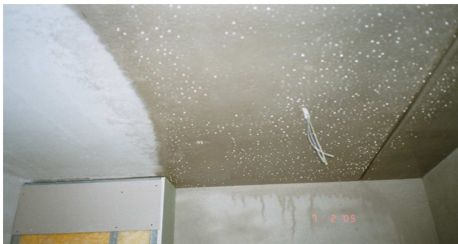
Rys. 10. Skroplona para wodna pokazuje obszar nieizolowany cieplnie a zarazem skuteczność ocieplenia
