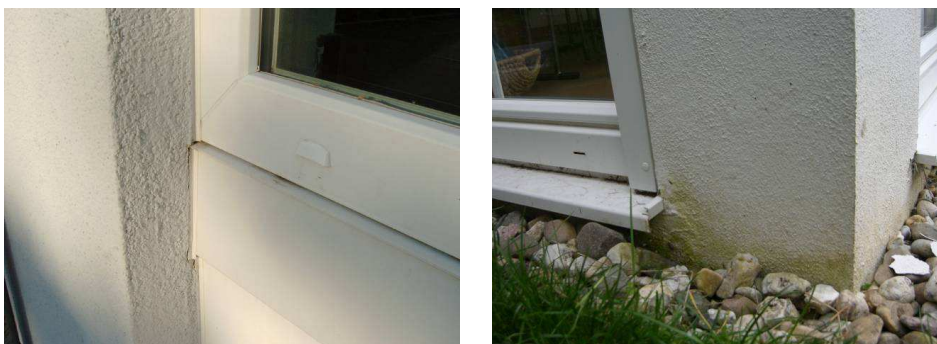
Rys. 2. W obu przykładach stwierdzono zawilgocenie ściany wewnątrz budynku
