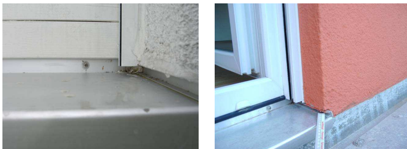
Rys. 1. W obu przykładach stwierdzono zawilgocenie ościeża okiennego wewnątrz budynku
