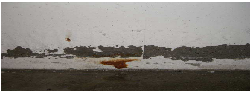
Rys. 6. Widoczne zawilgocenie jest wynikiem kondensacji pary wodnej, a nie jak mogłoby się wydawać, nieszczelności na styku ściany i płyty dennej garażu, posadowionego poniżej poziomu wód gruntowych
