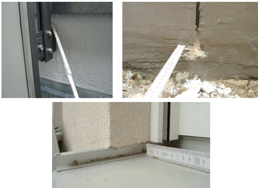
Rys. 3. a, b, c. Po lewej siatka zbrojeniowa jest nasiąkliwa i namoknięta powoduje uszkodzenie tynku. W środku styk dylatacyjny wadliwie wypełniony masą plastyczną z widocznymi rysami, Po prawej wadliwe zakończenie profilu dylatacyjnego masą plastyczną
