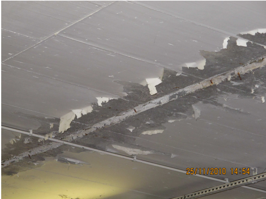
Rys. 3. Powłoka na betonie – rzeczywistość. Odspojona powłoka przy szczelinie dylatacyjnej, zbyt wąskiej aby ją pomalować. Parking pod domem towarowym
