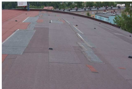
Rys. 3. Liczne ślady napraw pokrycia
