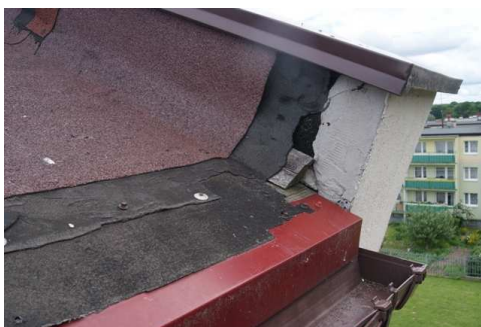
Rys. 4. Stan pokrycia na krawędzi dachu
