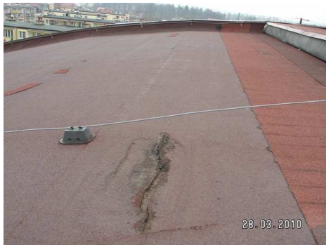
Rys. 2. Pęknięcie pokrycia dachowego
