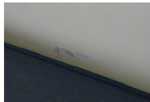
Rys. 12. Uszkodzenia tynku spowodowane podciąganiem kapilarnym
