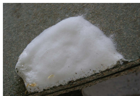
Rys. 10. Rozwinięta grzybnia grzyba – pleśń pod płytą włórową na spodniej powierzchni płyty włórowej
