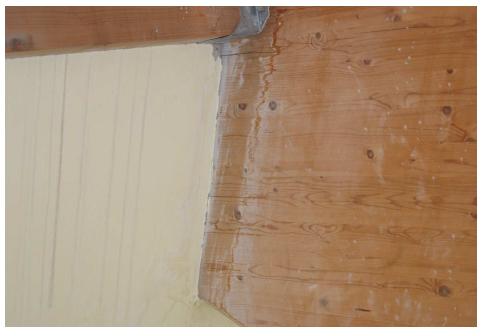
Rys. 5. Zacieki na ścianie i dźwigarze
