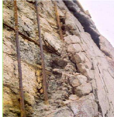
Rys. 6. Korozja betonu i stali zbrojeniowej
