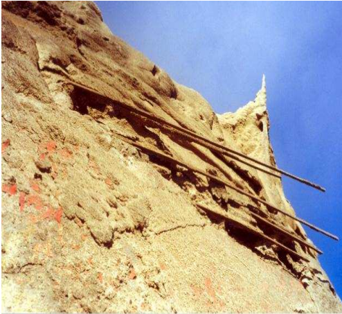
Rys. 5. Zasiarczenia i korozja zbrojenia
