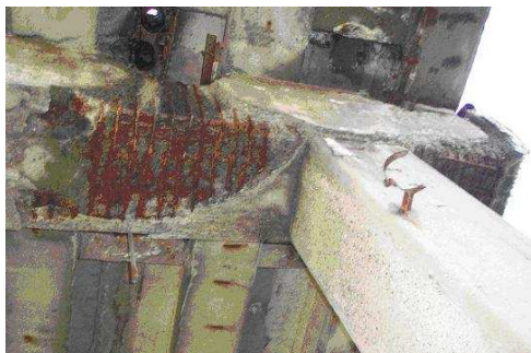
Rys. 1. Korozyjne uszkodzenia belki oczepowej i płyty pomostowej
