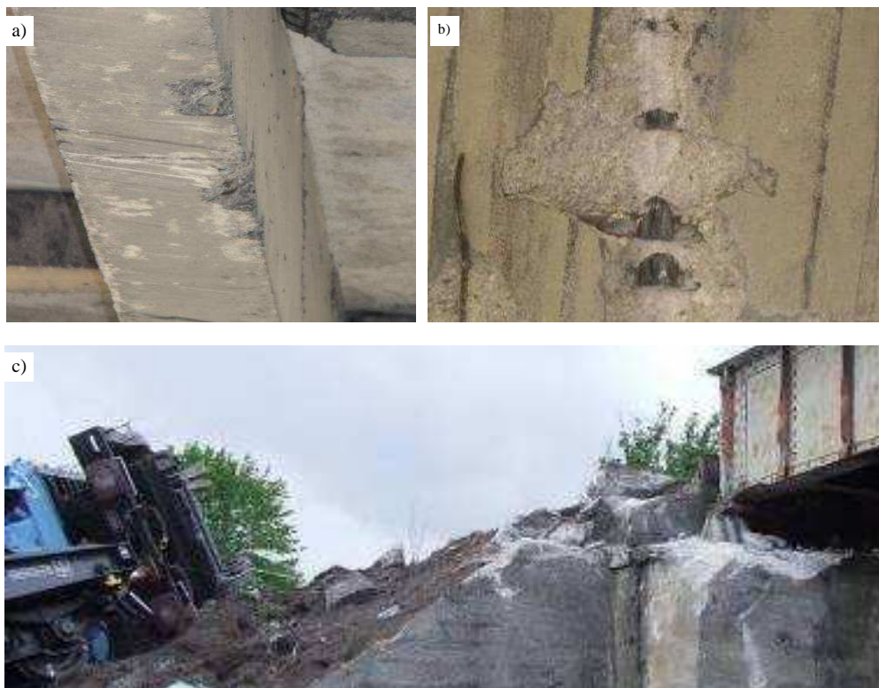
Rys. 1. Ubytki materiału spowodowane uderzeniami pojazdów: a) ubytek otuliny zbrojenia dźwigara, b) ubytek otuliny i prętów zbrojenia przęsła płytowego, c) ubytki betonu przyczółka
