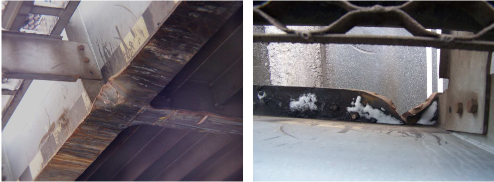
Rys. 8. Deformacja pasa dolnego dźwigara i poprzecznicy z widocznym pęknięciem
