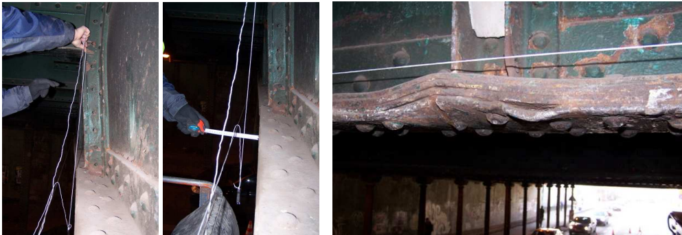
Rys. 5. Pomiar wychylenia dźwigara z pionu i zbliżenie na rejon uszkodzenia
