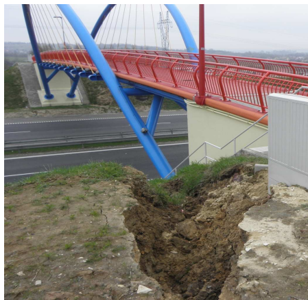
Rys. 2. Zniszczenia skarpy oraz złe odprowadzenie wody z obrębu kładki wynikające z nieprzestrzegania zaleceń SST oraz niskiej kultury pracy
