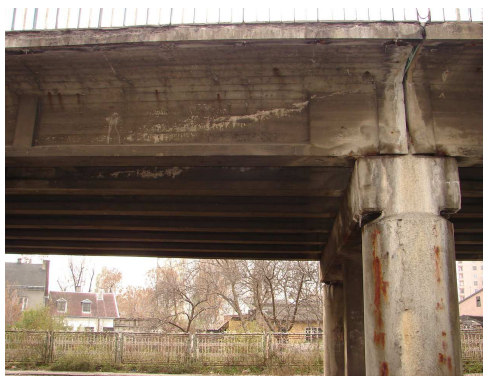
Rys. 2. Rysy ukośne w strefie podparcia i zakotwienia kabli
