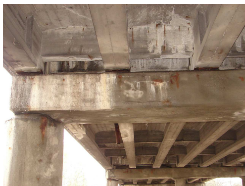
Rys. 1. Zarysowania belek, płyt, oczepów i filarów
