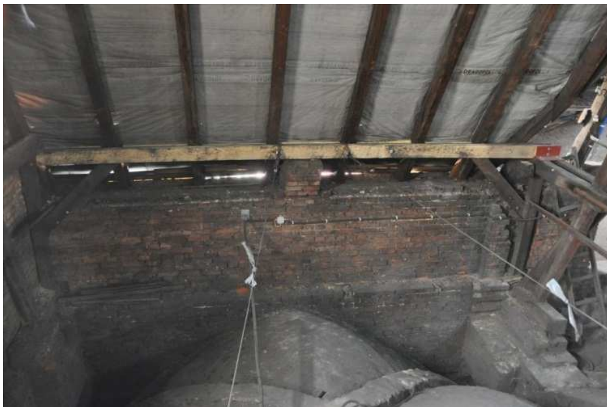
Rys. 7. Widok wzmocnionej murlaty nad transeptem (zwiększony przekrój i dodatkowe ściągi)
