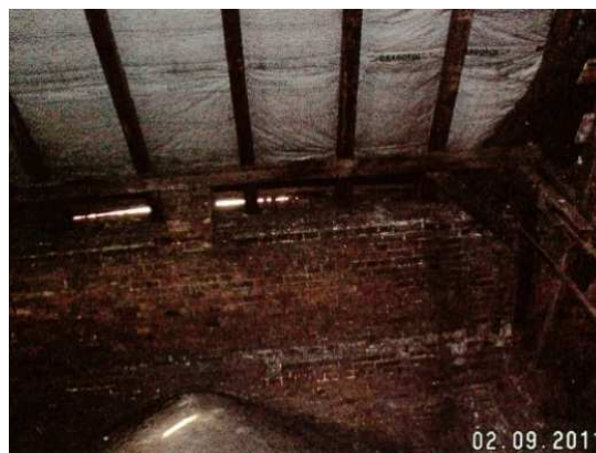
Rys. 6. Wyboczenie murłaty nad ścianą transeptu
