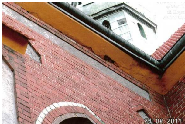
Rys. 5. Uszkodzenia gzymsu nad ścianą prezbiterium
