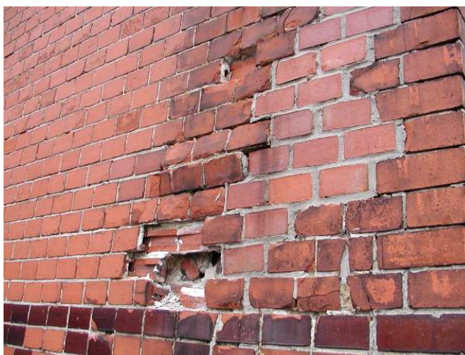
Rys. 5. Lokalne uszkodzenie warstwy elewacyjnej; widoczne przemurowania
