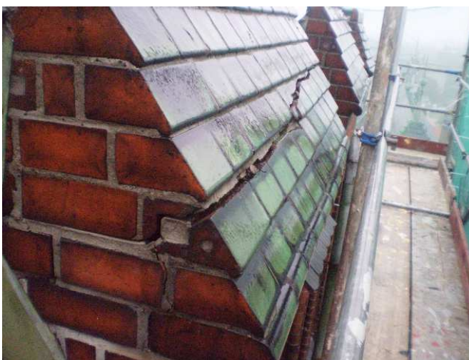
Rys. 6. Lokalne uszkodzenie blankowania w poziomym dachu
