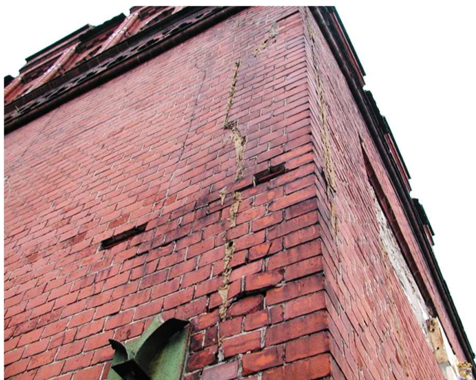
Rys. 3. Rysy pionowe w zachodnim narożu wieży
