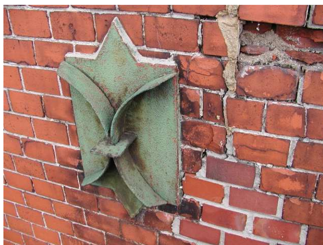
Rys. 8. Blacha oporowa ściągu; widoczne uszkodzenia i przemurowania warstwy elewacyjnej
