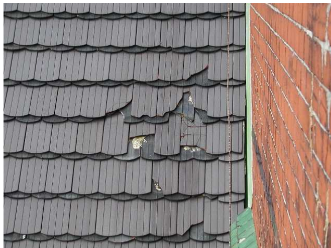
Rys. 7. Dachówki uszkodzone przez spadające kształtki elewacyjne
