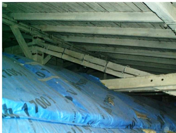
Rys. 9. Scalony stalowymi obejmami silnie spękany zastrzał
