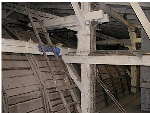
Rys. 5. Widok fragmentu konstrukcji wiązara po zdjęciu warstw izolacji. Widoczne wzmocnienie słupa głównego
