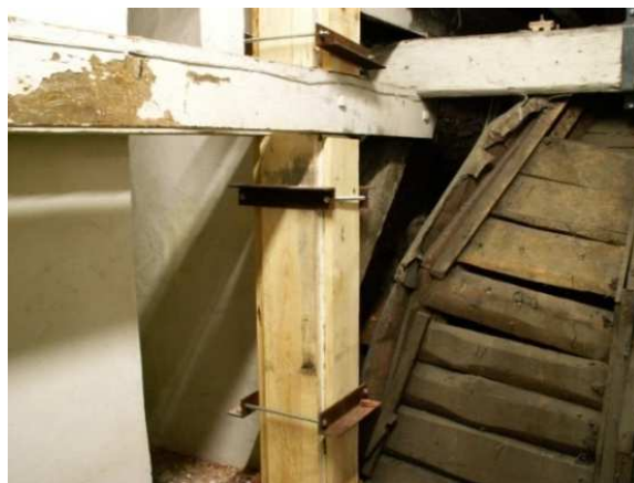
Rys. 14. Wzmocnienie uszkodzonego korozyjnie słupa głównego
