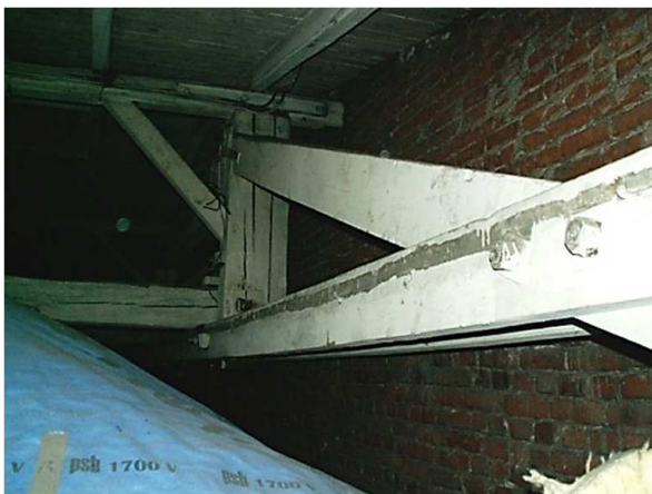
Rys. 8. Silne spękania wieszaka w wiązarze skrajnym
