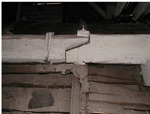
Rys. 11. Obluzowanie połączenia kolejnych odcinków belki podłużnej
