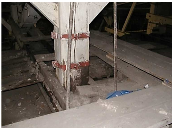
Rys. 10. Pęknięcie przechodzące przez śrubę mocującą stalową obejmę do wieszaka
