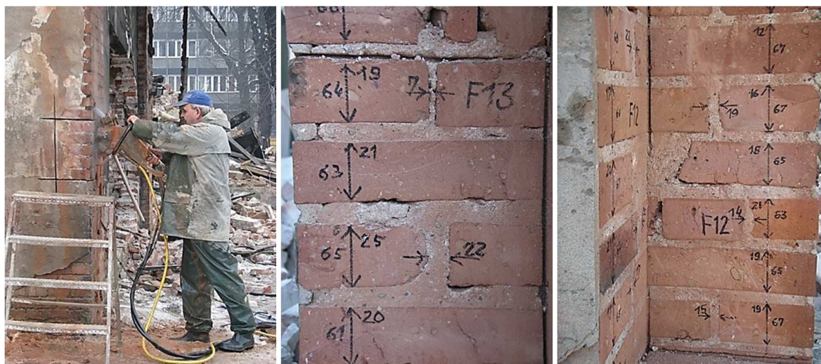
Rys. 2. Etap wycinania elementów próbnych z filarów oraz przykładowe przekroje murów w płaszczyznach cięcia
