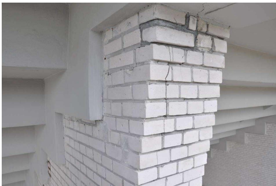
Rys. 5. Uszkodzenia ściany podporowej trybun - czoło ściany
