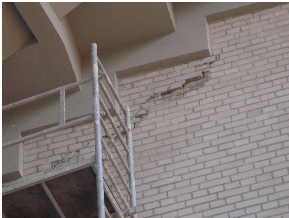
Rys. 4. Uszkodzenia ściany podporowej trybun
