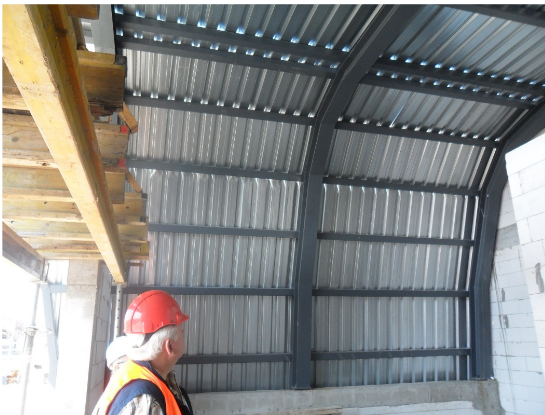
Fot.1. Widok konstrukcji nośnej stalowej i zewnętrznego poszycia z blachy trapezowej dachu
