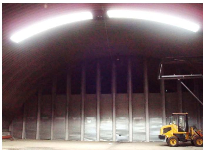
Rys. 5. Stopione świetliki dachowe oraz widok na ścianę działową (za bramą nr 4)
