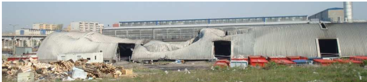
Rys. 4. Zniszczona hala magazynowa (bramy 1, 2, 3)
