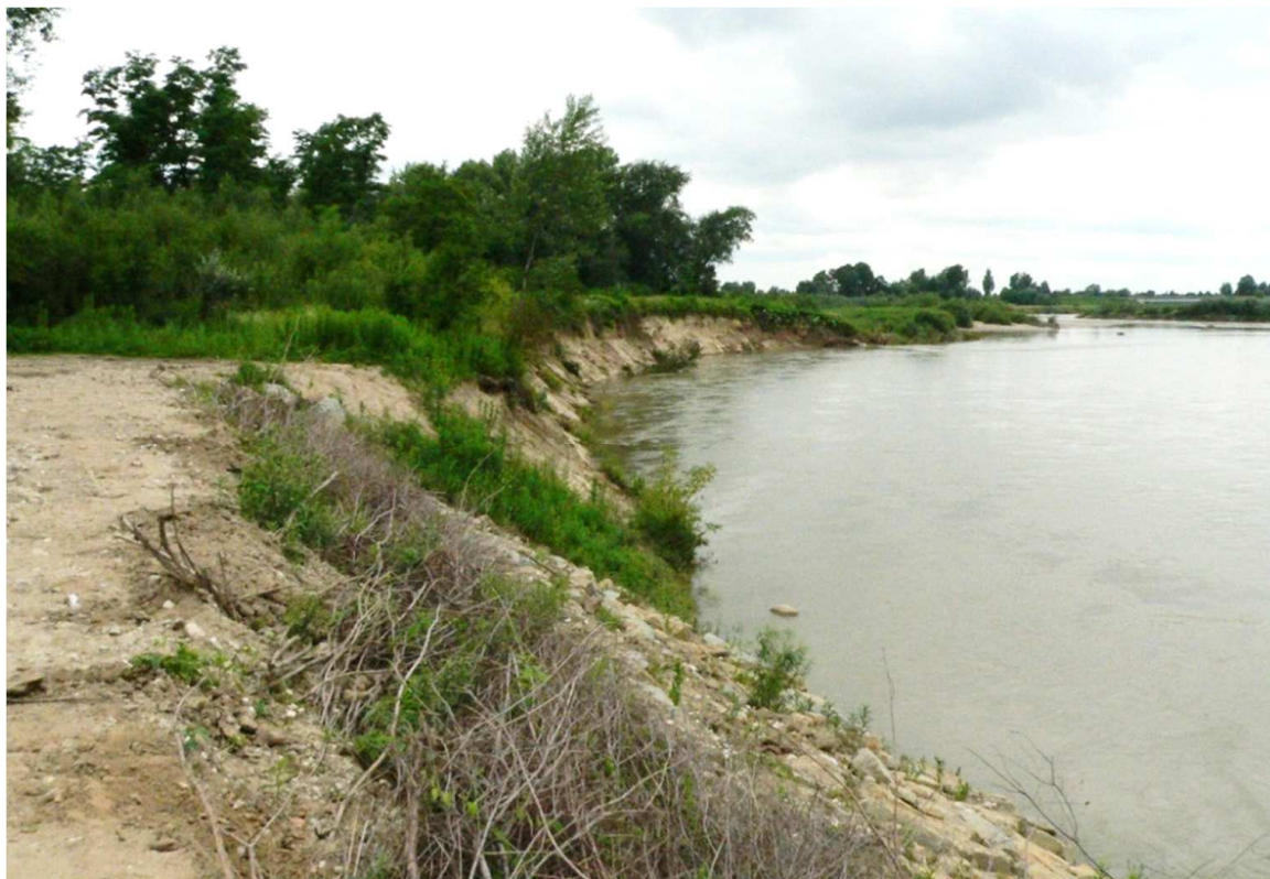
Rys. 1. Widok na skarpe w rejonie słupa
