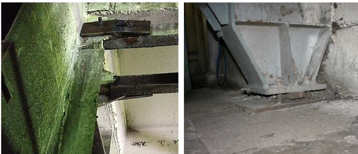
Rys. 8. Naprawione połączenie rygla przybudówki z słupem budynku nadszybia w osiach 3 i C
