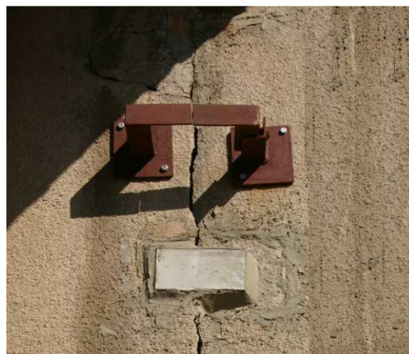
Rys. 12. Pęknięcie na łączniku dylatacyjnym segmentu L-2 kanału wentylacyjnego
