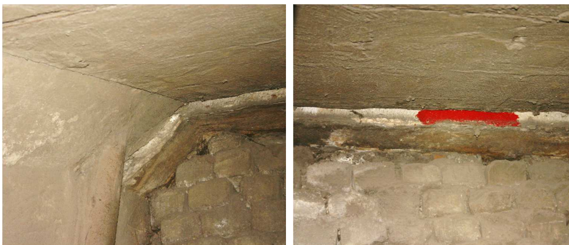
Rys. 7. Przemieszczenie pionowe na łączniku segmentu L-1 kanału wentylacyjnego z głowicą szybową zarejestrowane od strony szybu
