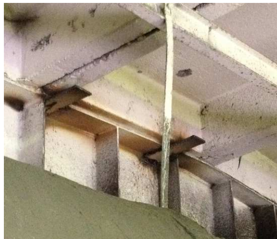
Rys. 11. Nieprawidłowe podparcie płyty korytkowej przybudówki w osi 3
