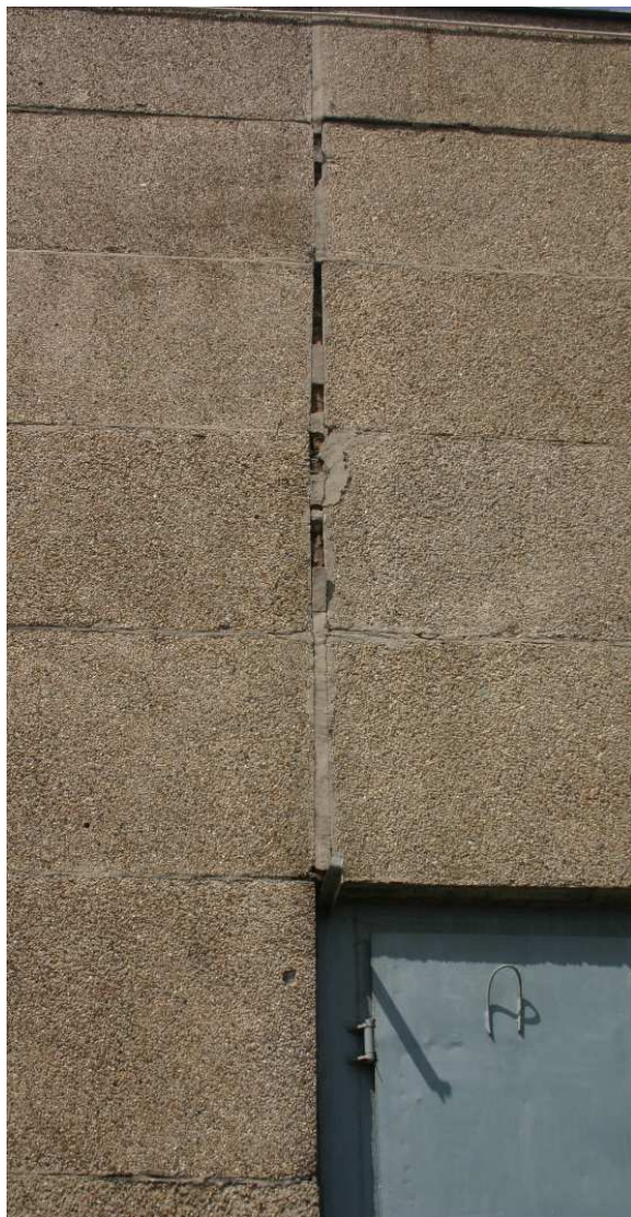
Rys. 10. Klawiszowanie płyt ściennych, odspojenia i niewielkie przemieszczenia poziome i pionowe
