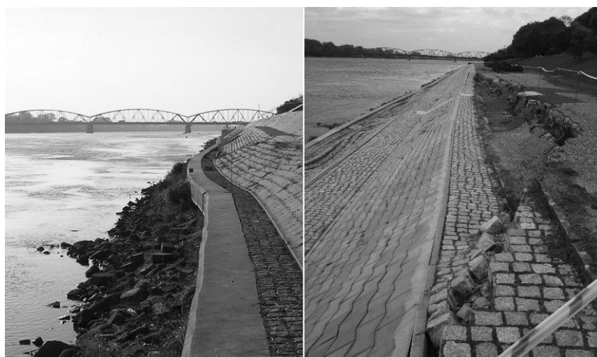
Rys. 3. Widoczne przemieszczenie oczepu (z lewej) oraz nisza zsuwu (z prawej) [6]
