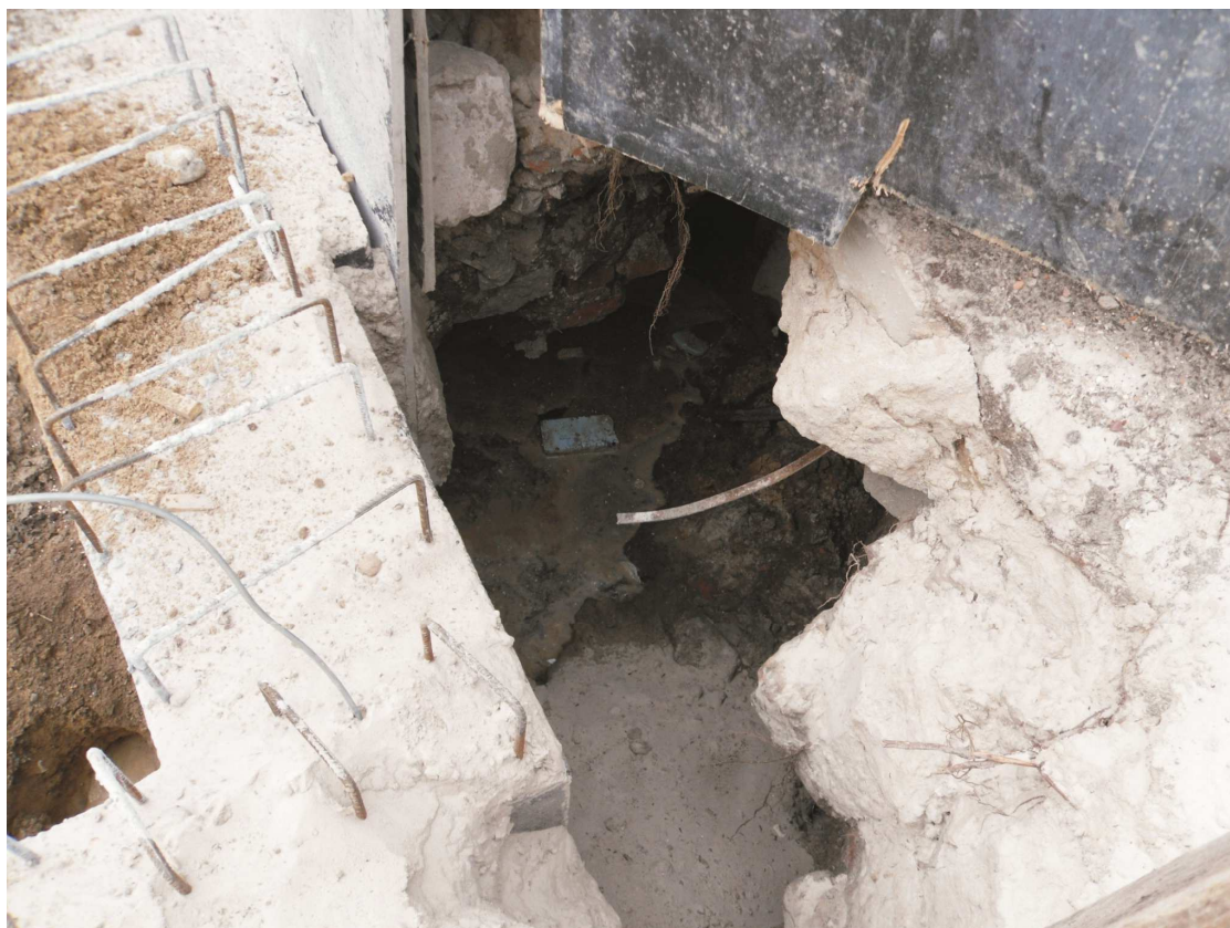
Rys. 1. Zapadlisko zewnątrz obudowy wykopu (aut. Biuro budowy) [1]
