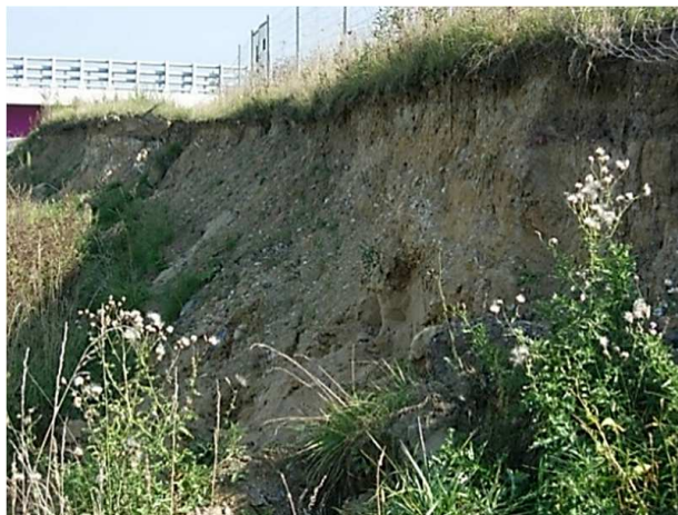
Fot. 3. Rejon najgłębszego zasięgu osuwiska i największego przesunięcia wodociągu
