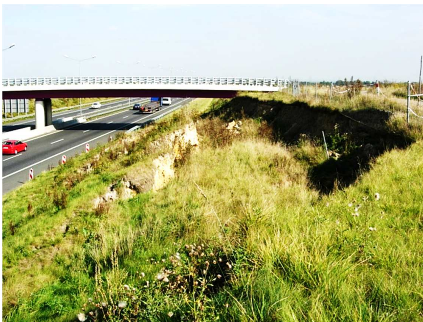
Fot. 1. Widok osuwiska w km 308,460-308,500
