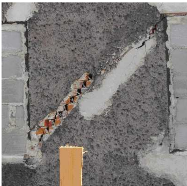
Rys. 5. Ukośne spękanie pasma międzyokiennego z przemieszczeniem ok. 5 cm w budynku nr 4 szeregu a)
