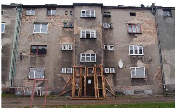
Rys. 7. Spękania w obrębie wykuszy budynku nr 13 szeregu b)
