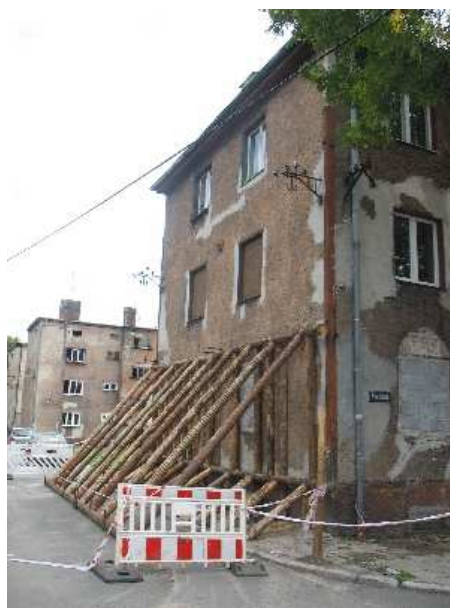
Rys. 6. Deformacja oraz poziome ścięcie „wepchnięcie” ściany szczytowej budynku nr 2 w szeregu a)
