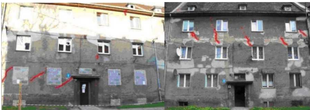
Rys. 13. Uszkodzenia zachodnich ścian zewnętrznych segmentów 6 i 8
