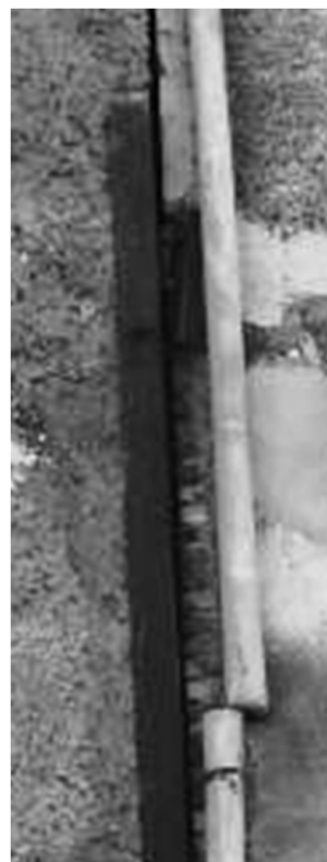
b) zaciśnięta dylatacja pomiędzy segmentami nr 4 a 6
