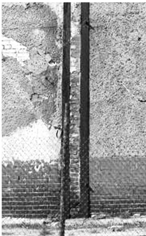
a) zamurowana dylatacja pomiędzy segmentami nr 2 a 4
