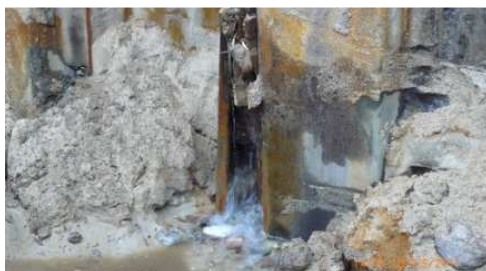
Rys. 6. Rozszczelnienia i przerwy ścianki szczelnej w strefie bruku morenowego
