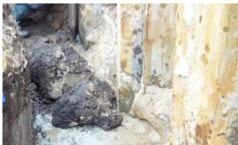
Rys. 5. Przykład ucieczki betonu z formowanych pali
