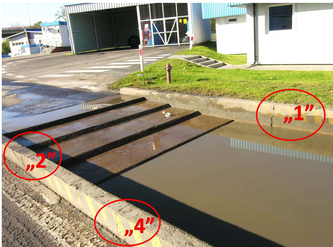
Rys. 7. Spękania ścian brodzika dezynfekcyjnego po stronie PD
