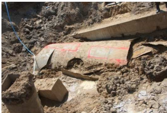
Rys. 4. Widok uszkodzonych zbiorników po odśnieżeniu
