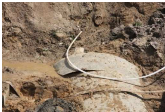
Rys. 5. Widok uszkodzonych zbiorników po odśnieżeniu
