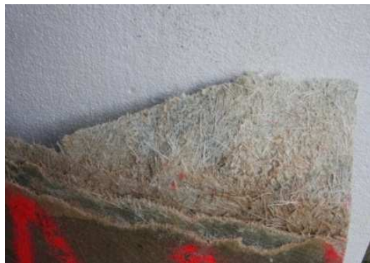
Rys. 7. Widok delaminacji płaszczu zbiornika w stanie krytycznym na połączeniu płaszczu i dennicy
