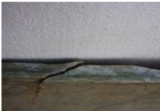
Rys. 6. Widok linii zniszczenia na płaszczu zbiornika, na drugim i szóstym pierścieniu licząc od dennicy zbiornika
