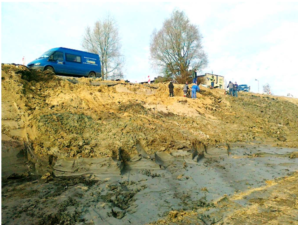
Rys. 3. Nisza (gdzie realizowane są badania kontrolne) i jęzór osuwiska skarpy nad budowaną ulicą. Widoczne zawilgocenie dolnych partii jęzora osuwiskowego to efekt sączącej się w skarpie wody
