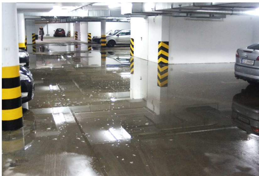
Rys. 5. Posadzka posadowionego w iłach garażowca zalana po roztopach w styczniu 2011 r.
