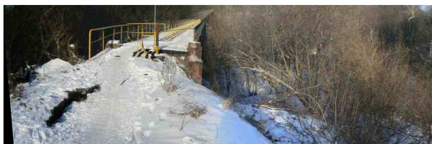
Rys. 2. Widok korony nasypu – oznaki inicjacji ruchu osuwiskowego
