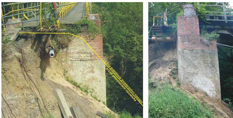
Rys. 5. Przyczółek mostu odsłonięty w wyniku osuwiska: widok od strony pld.-zach. i pld.-wsch.
