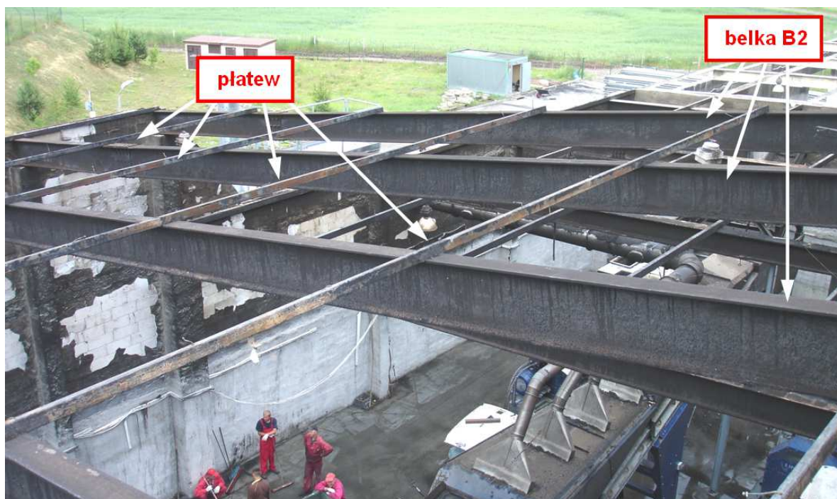
Rys. 3. Widok konstrukcji nośnej dachu hali produkcyjnej po pożarze
