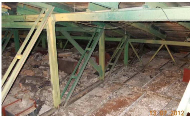
Rys. 10. Spodek dolny -widok na dźwigar kratowy, pas dolny usztywniony rusztem z kratą
