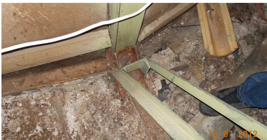
Rys. 9. Spodek dolny - korozja węzła dolnego kratownicy, połączenie z pierścieniem środkowym
