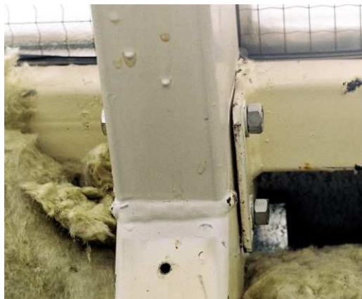
Rys. 5. Stan połączenia rygla okapowego z ramą
