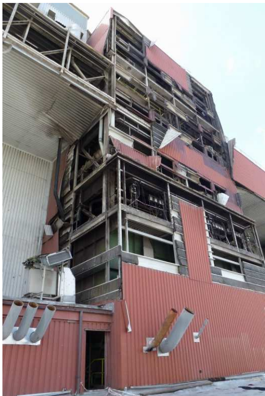
Rys. 2. Ogólny widok uszkodzeń fragmentu obudowy ściennej budynku kotłowni
