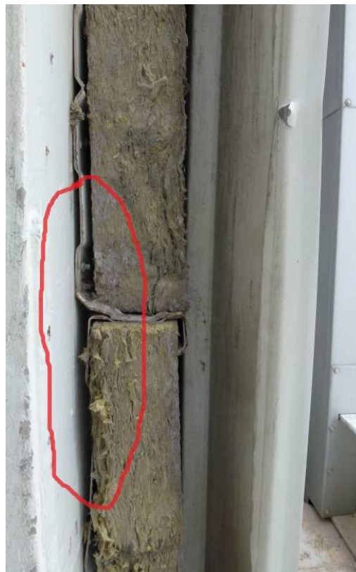
Rys. 3. Widok fragmentu pozostającej obudowy ściennej z uszkodzonym łącznikiem dolnej kasety
