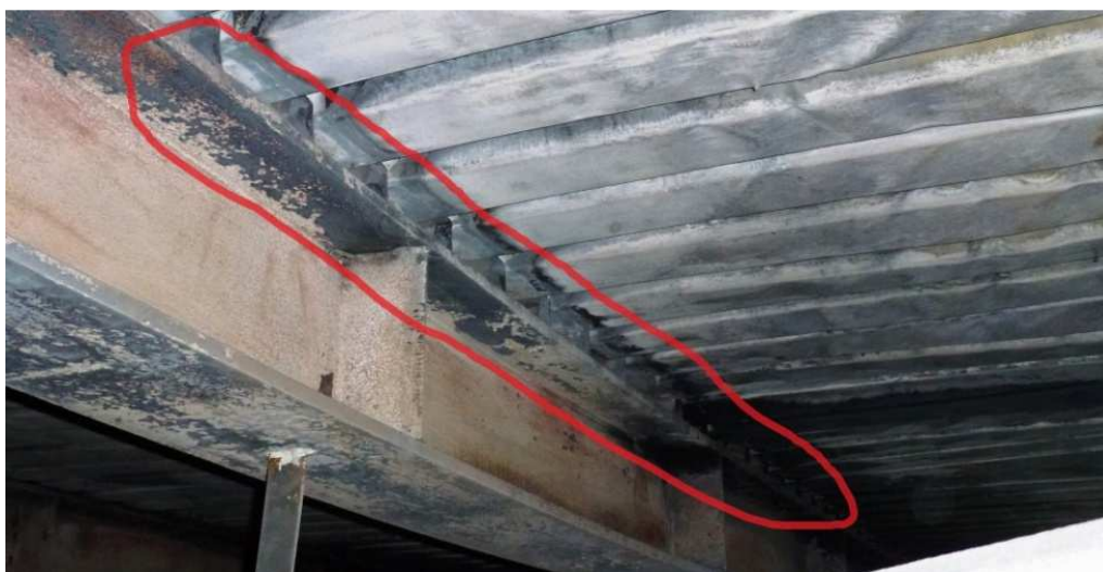
Rys. 11. Plastyczne ugięcie belki stropu +41,5 m nad zasobnikiem +38 m wskutek przegrzania
