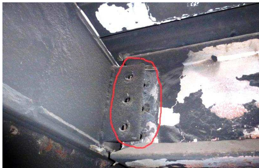
Rys. 9. Widok zniszczonego połączenia śrubowego belki I340 (strona prawa) z belką główną B3 (strona lewa) wg oznaczeń na rys. 7, 8
