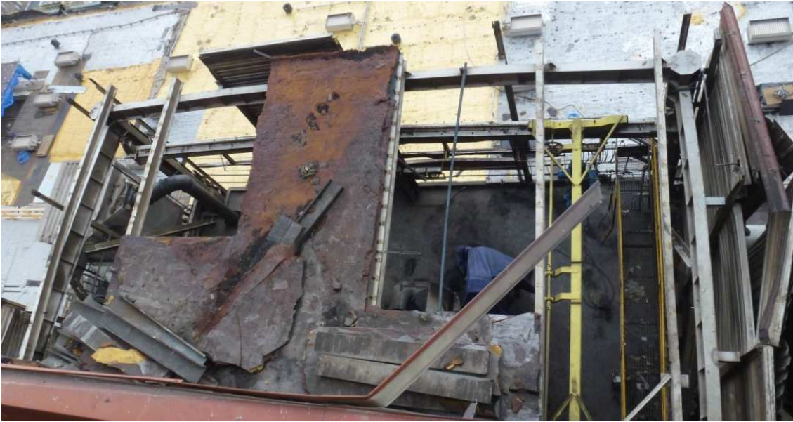
Rys. 6. Widok uszkodzeń głównej konstrukcji nośnej poddachowej części wieży W2 (wg rys. 1)
