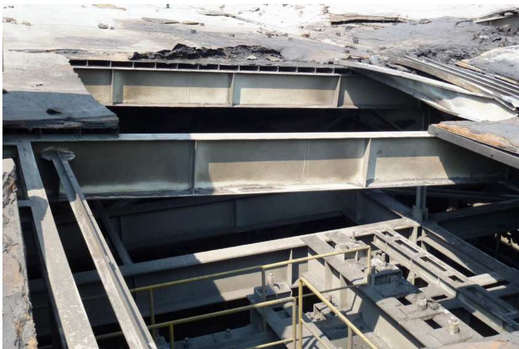
Rys. 5. Widok fragmentu uszkodzeń pokrycia dachu budynku kotłowni
