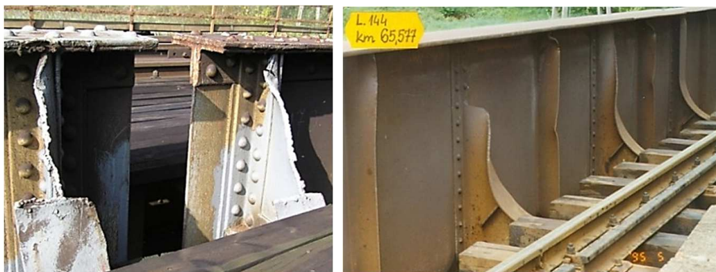
Rys. 1. Charakterystyczne uszkodzenia żeber poprzecznych wywołane uderzeniami pojazdów poruszających się po obiekcie [2]
