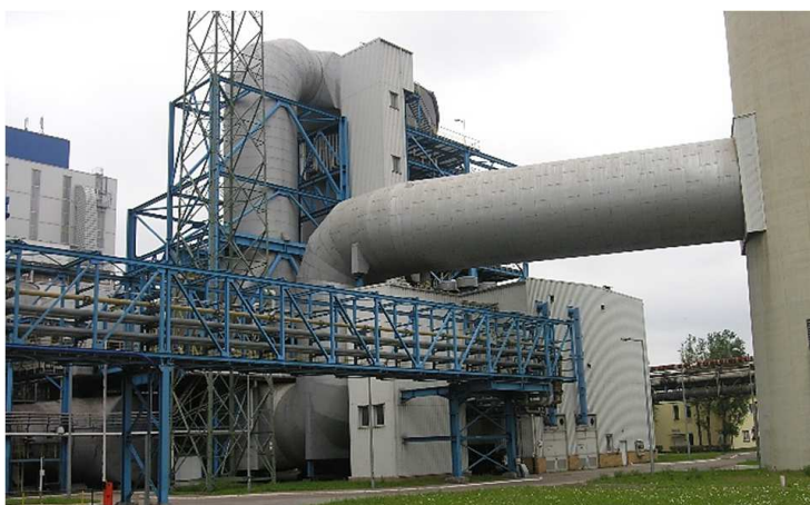
Rys. 1. Ogólny widok kanału czystych spalin biegnącego od stacji filtrów (z lewej), ponad klatką schodową stanowiącą podpory 11 i 12 (w środku), do komina żelbetowego (z prawej)
