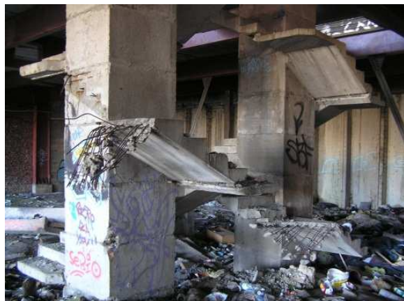
Rys. 5. Uszkodzone biegi schodowe – pawilon północny
