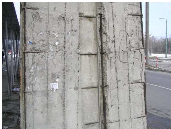
Rys. 4. Uszkodzenia dwukondygnacyjnego słupa żelbetowego – pawilon północny
