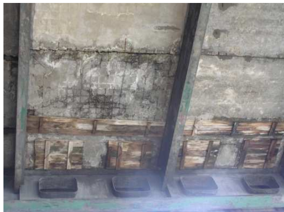
Rys. 7. Uszkodzenia żelbetonowych płyt stropowych – pawilon północny
