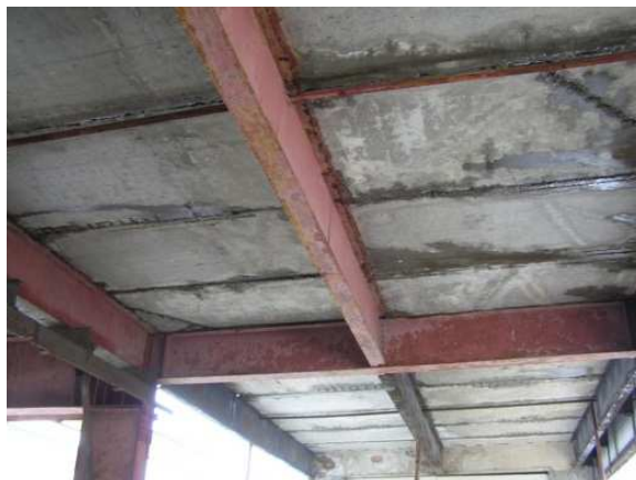
Rys. 8. Pęknięte płyty stropowe – pawilon południowy
