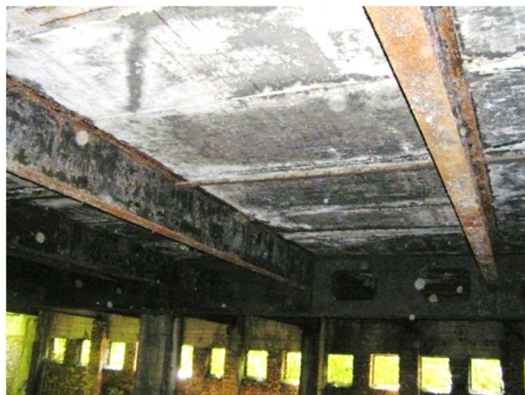
Rys. 3. Korozja żeber stropu pierwszej kondygnacji – pawilon południowy
