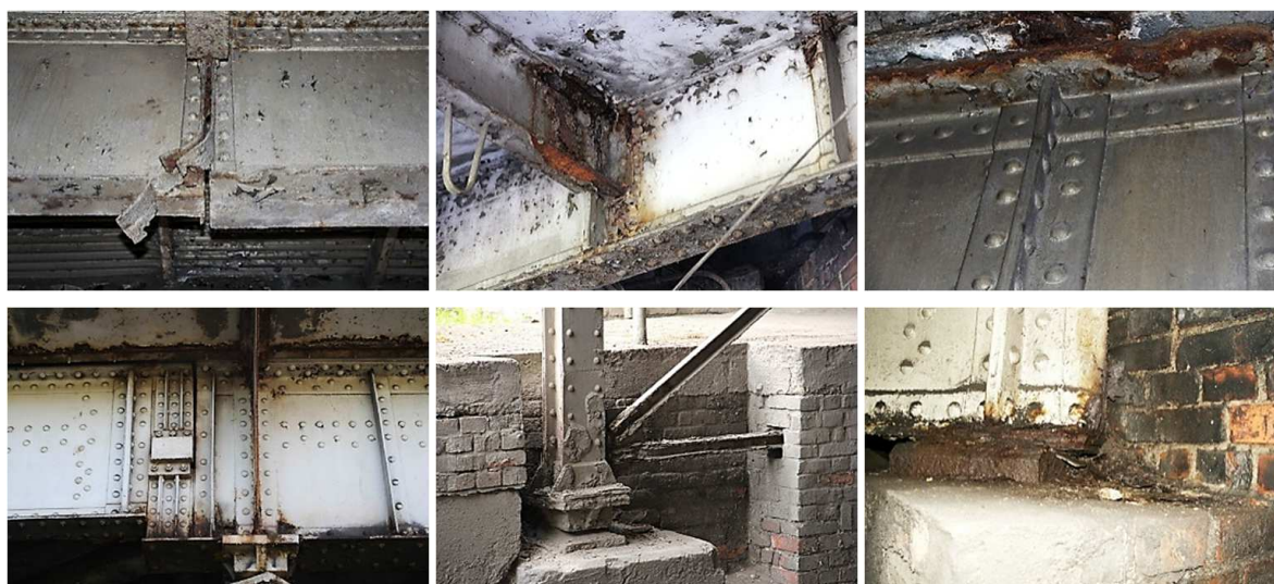
Rys. 3. Uszkodzenia konstrukcji przeseł – mechaniczne uszkodzenia dźwigarów w obrębie przegubu oraz korozja elementów pomostu, dźwigarów głównych oraz podpór
