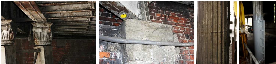
Rys. 4. Uszkodzenia konstrukcji podpór – pęknięcia i deformacje słupów i głowic filarów, pęknięcia ciosu podłożyskowego
